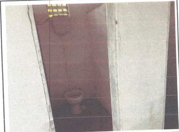
FOTO Nº BANHEIROS 16 BACIA SANITÁRIA E CAIXA DE DESCARGA
