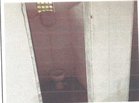
FOTO Nº 16 BANHEIROS BACIA SANITÁRIA E CAIXA DE DESCARGA
